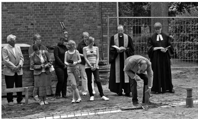
Einsenkung der Urkundenkapsel bei der Grundsteinlegung in Groß Oesingen. Foto: Heinrich Harms, Groß Oesingen
